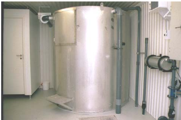
Biobädden, byggd i rostfritt stål SS2333.
