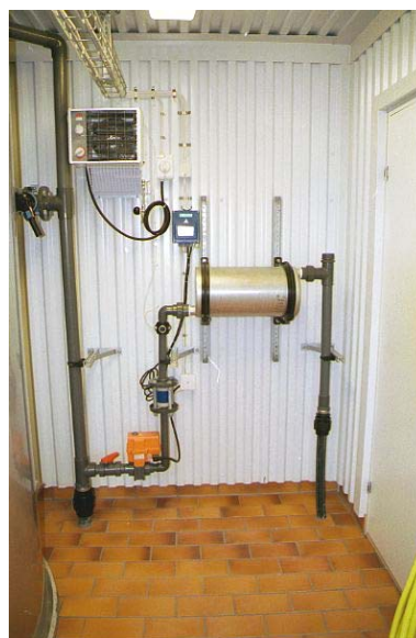
Den statiska mixern, flödesmätaren, motorventilen och värmefläkten.
