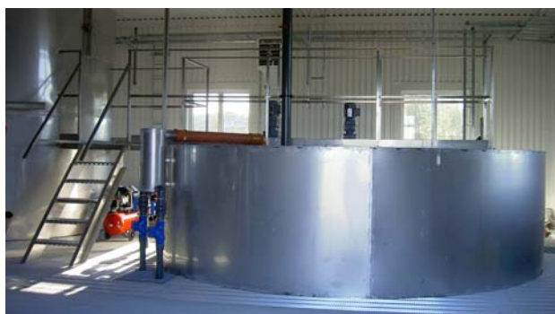
Sedimenteringsbassängen med diametern 4,3 \text{ m} är utrustad med plattformar för åtkomlighet både upp på och runt om.
