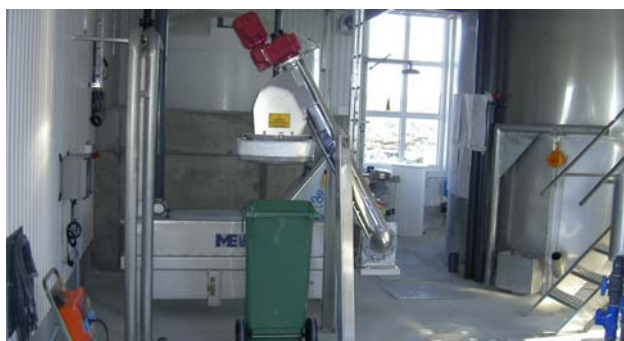
I förgrunden syns förbehandlingen i form av ett finrensgaller. Renset tvättas och pressas sedan ut och förvaras i en "plaststrumpa". Bakom rengallret är kemikalietanken som rymmer 10 \text{ m}^3 fällningsmedel placerad.
