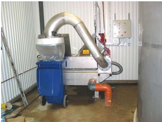
Förbehandlingen (mekaniska reningen) sker i ett finrensgaller. Renset tvättas och pressas sedan ut och förvaras i en "plaststrumpa". Därefter transporteras det till sopförbränning.
