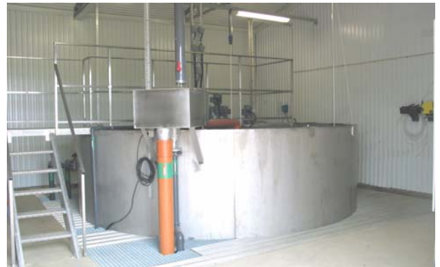
Sedimenteringsbassängen som har diametern 4,5 m, är utrustad med plattformar för åtkomlighet både uppe på och runt om.
