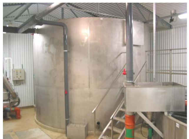
Biobädden, byggd i rostfritt stål SS2333. Trappa och plattform för total åtkomlighet i anläggningen.
