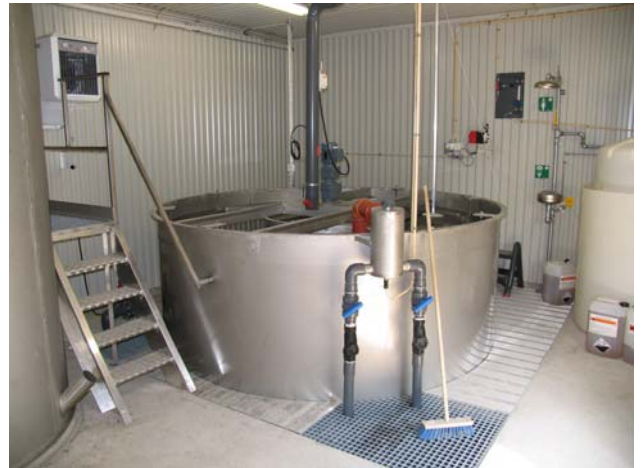
Sedimenteringsbassängen som har en diameter av 3,0 m, är nedsänkt i golvet för åtkomlighet både uppe på och runt om.
