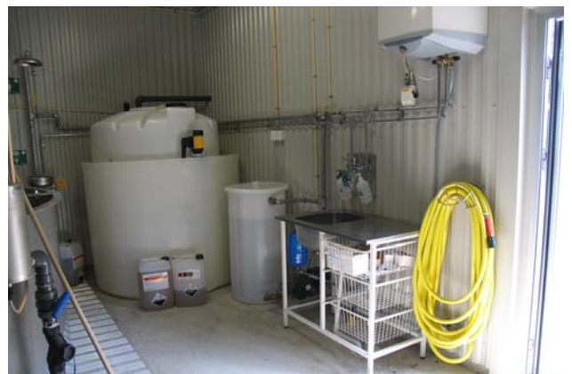
Invallad kemtank för fällningskemikalier samt diverse installationer såsom diskbank. Spolslang, brutet vatten mm
