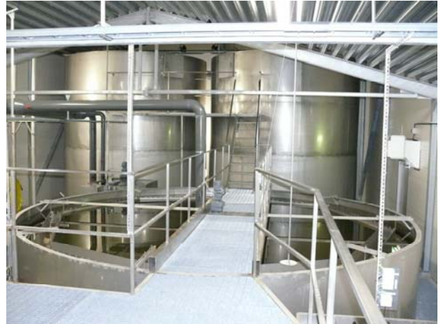
Sedimenteringsbassängen som har en diameter av 7,0 m, är utrustad med plattformar för åtkomlighet både uppe på och runt om.
