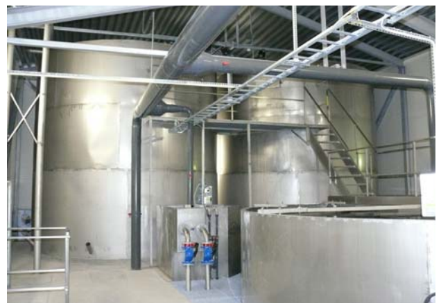
Biobäddarna, byggda i rostfritt stål SS2333. Trappa och plattform för total åtkomlighet i anläggningen.
