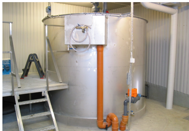
Sedimenteringsbassängen, mitt i bilden, är utförd i rostfritt stål med en diameter av 2,5 m. Plattformen, som är placerad mellan biobädden och sedimenteringen, ger bra arbetsförhållanden.
