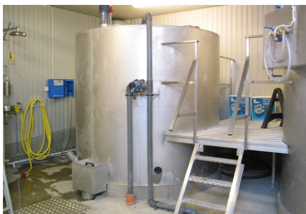
Biobädden, mitt i bilden, är utförd i rostfritt stål. Placeringen av enheterna tillsammans med en plattform ger en mycket god åtkomlighet i anläggningen.
