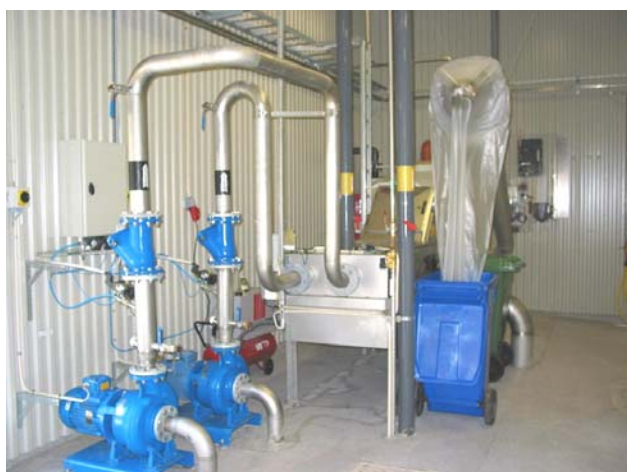
I förgrunden till vänster syns de båda torruppställda inloppspumparna som pumpar till förbehandlingen (mekaniska reningen) i form av ett finrensgaller. Renset tvättas, pressas och förvaras därefter i en "plaststrumpa" för att slutligen brännas
