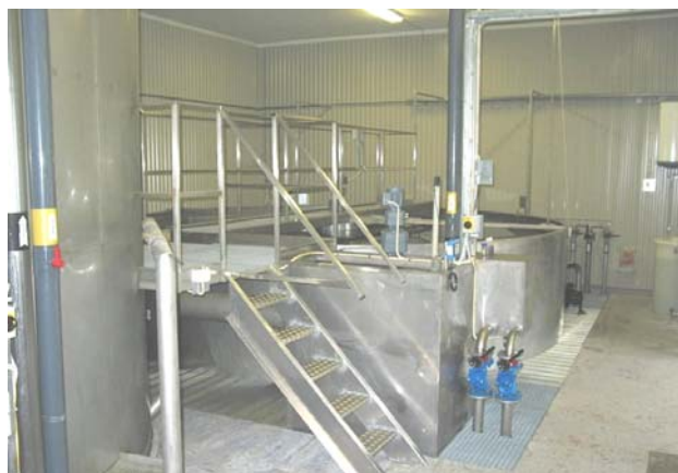
Sedimenteringsbassängen som har en diameter av 6 m, är utrustad med plattformar för åtkomlighet både på och runt om.
