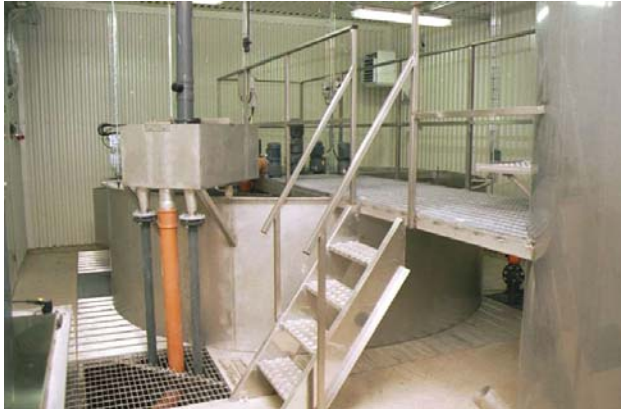
Sedimenteringsbassängen med konstant- flödeslåda för reglering av inkommande avloppsvatten.
