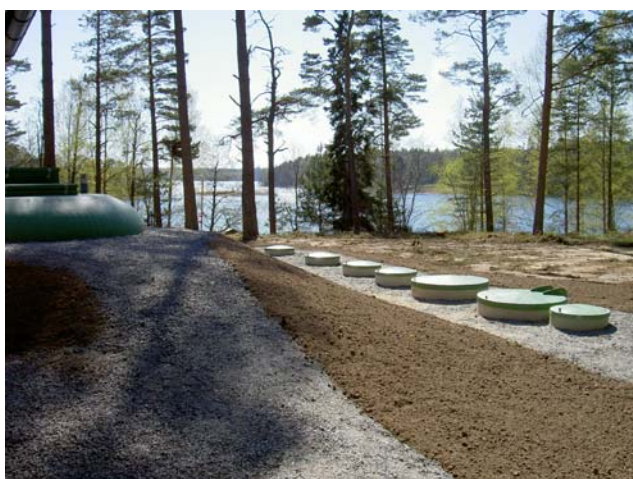
Bilden visar den högra av de två linjerna i reningsverket.
